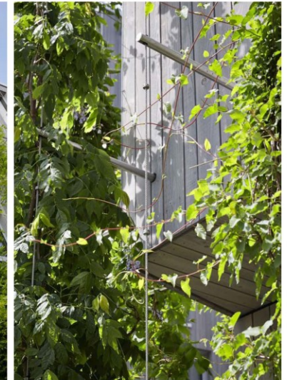
kabels langs houten gevelbeplating
